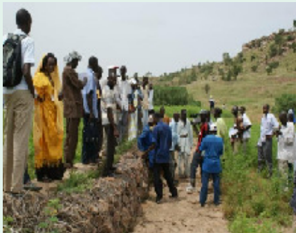
Visite d'un barrage à cordons pierreux pour lutter contre l'érosion hydrique et la reconstitution des terres productives dans le village de GOUGNA département de Bakel. Photo Enda.
